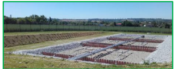
Exemple de station au démarrage (avant la pousse des roseaux), 180 EH
